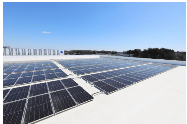
■ 鶴ヶ島工場屋上 太陽光パネル
